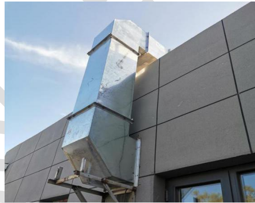
油烟排气管道
