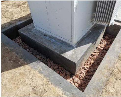
事故废油导流槽
