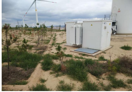
风机机位箱变处现状
