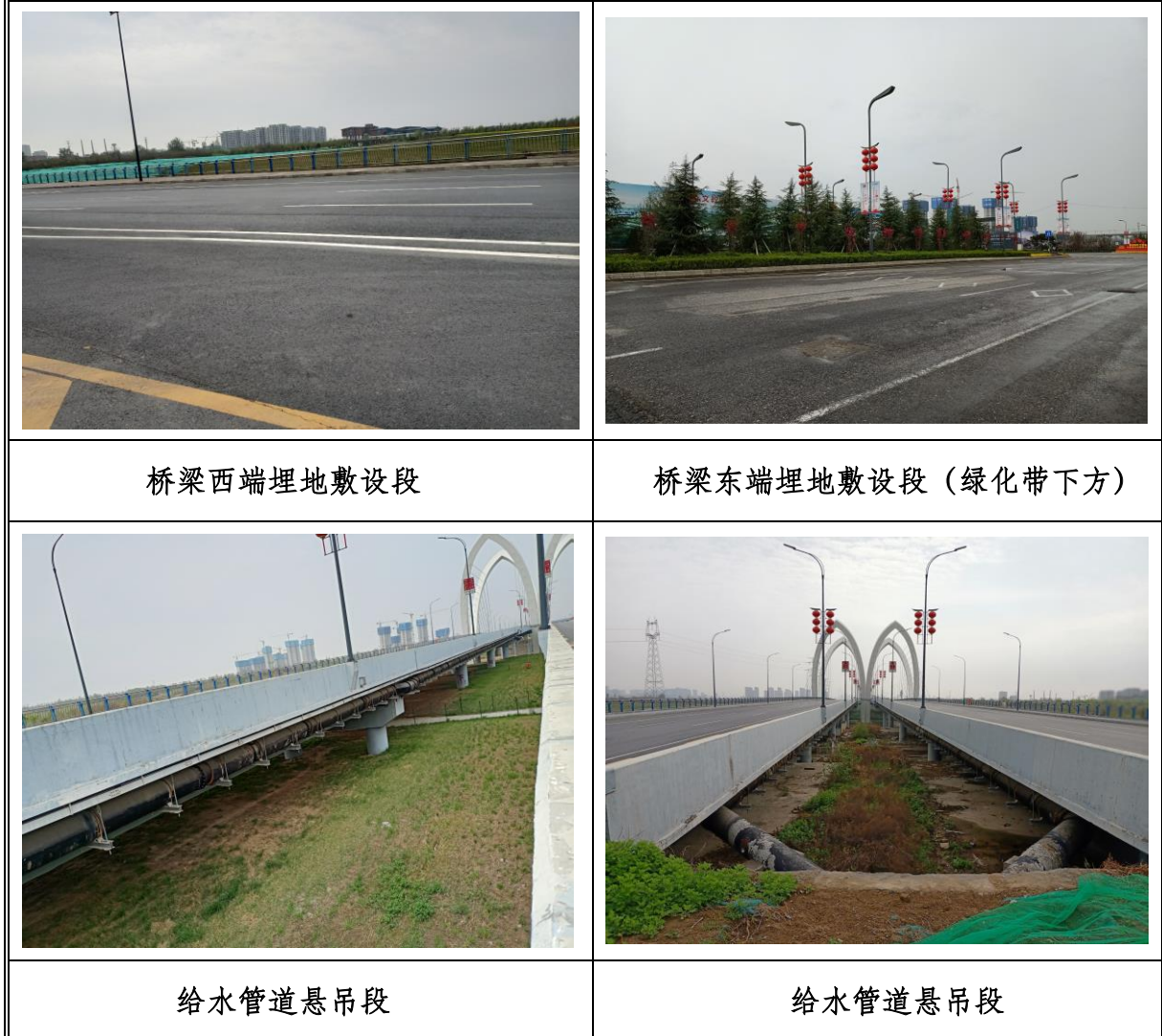
图 4-1 给水管道布置现状照片
